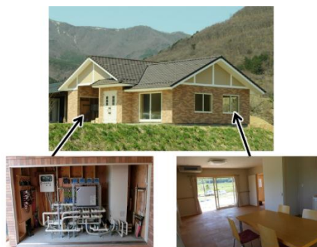
地中熱ヒートポンプと室内
