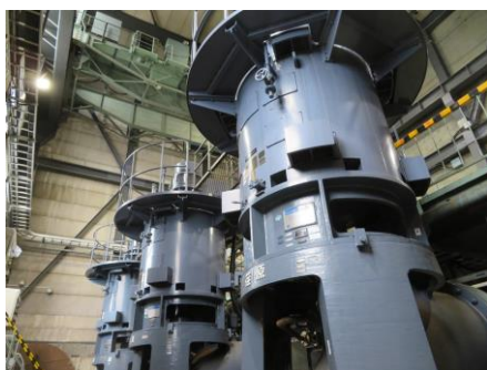
小名浜工業用水道ポンプ設備 (520kw×4基 1基あたり 150m 3 /分) 企業局で設置しているポンプの中 で最も大きなポンプです。
