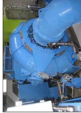
発電所内 横軸フランシス水車
