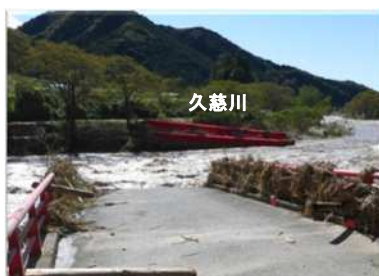
町道橋の落橋／高原橋（矢祭町）
