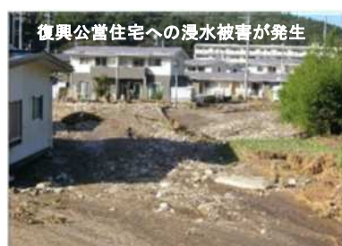
復興公営住宅の被害／壁沢団地（川俣町）
