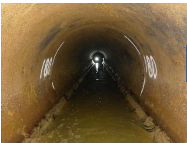
耐震性能不足の管渠
