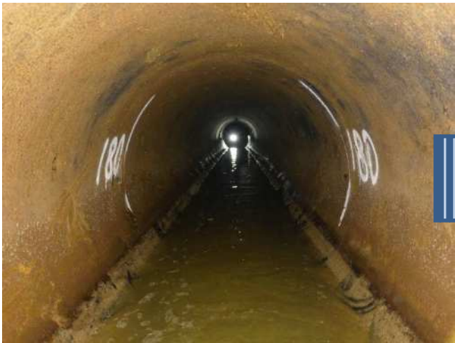
耐震性能不足の管渠
