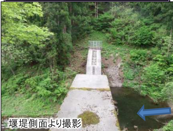
【before】被災前(平成29年5月撮影)
