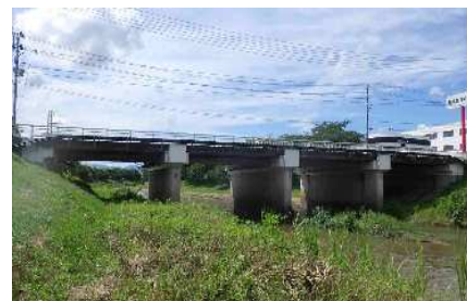
郡山停車場線 永盛橋(郡山市) 【橋梁補修事業】 橋梁点検結果を踏まえ、伸縮装置及び高欄補修等を実施する。
