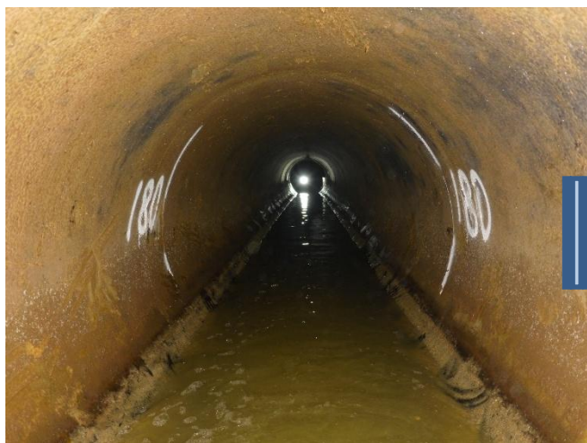
耐震性能不足の管渠
