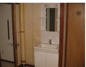
③洗面所へキャビネット型洗面化粧台設置(シングルバ-混合水栓付き)
