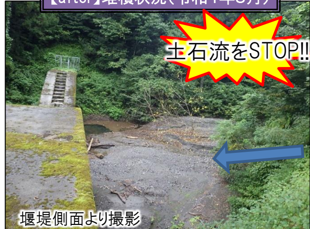
【after】堆積状況(令和4年8月)
