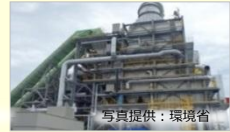
仮設焼却施設
