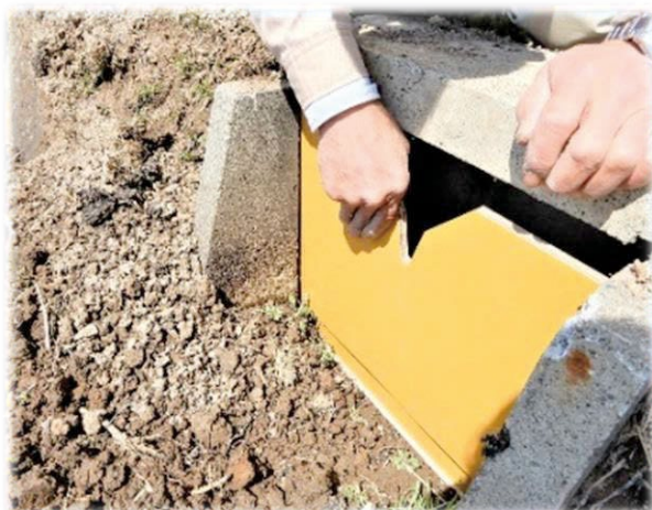
■コンクリート製の排水マス
