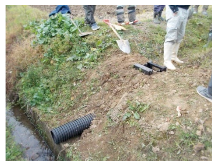
設置方法の説明会で現場に設置した排水調整器具の状況
