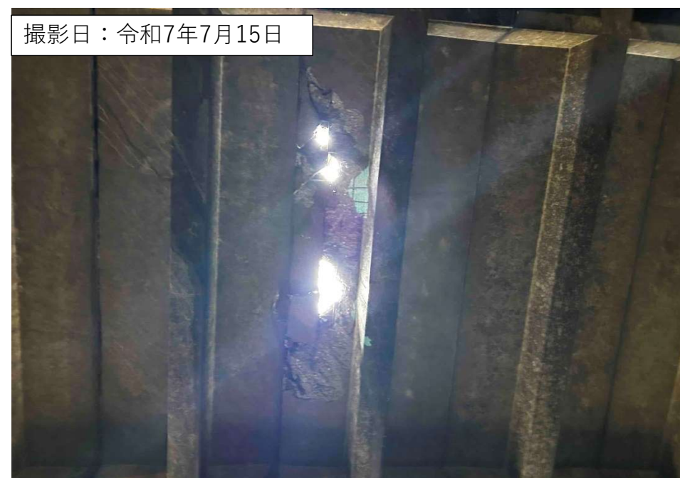
スノーシェッド上部には穴があいている状態
