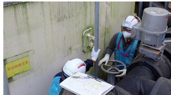
(写真 5) 排水弁の全開作業
