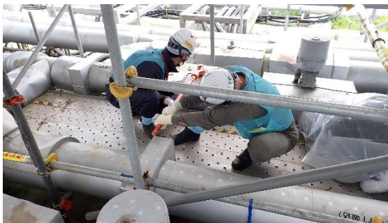
(写真2) 排水弁の全開作業
