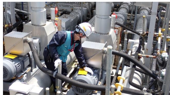
(写真 3) ポンプ起動後の確認
