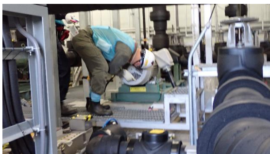
(写真 6) ポンプ起動後の確認
