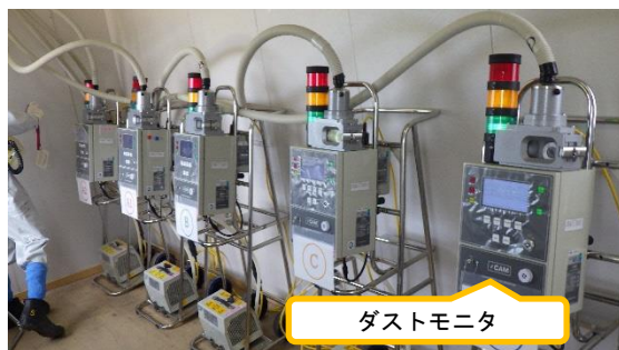
(写真 2－2) ダストモニタの設置状況②
