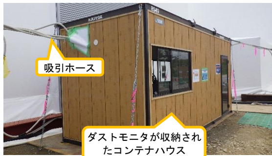
(写真 2－1) ダストモニタの設置状況① ※コンテナハウス内にダストモニタが設置されている。
