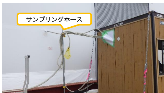
(写真 2－3) ダストモニタサンプリングホースの設置状況
