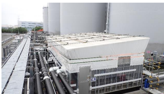
(写真 3) 移送先 K 4 タンク エリア の 状況 (測定・確認用タンク C 群への 導水前に高性能フィルタを設置)
