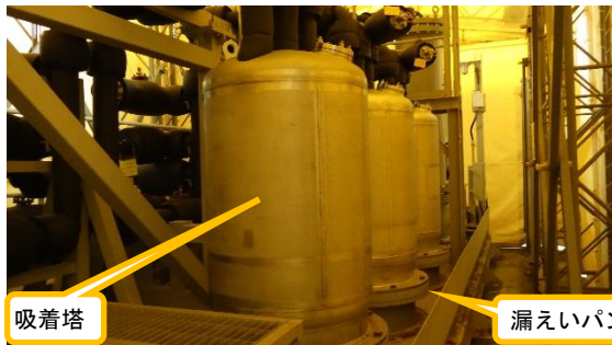
(写真 2 ①) 漏えいパン内に設置された構成機器
