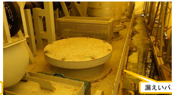
(写真 2 ②) 漏えいパン内の状況
