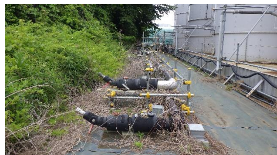
(写真 4) 散水口の状況
