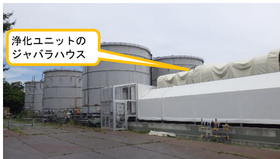
(写真 1 ①) 浄化ユニット外観
