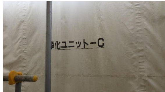
(写真 1 ②) 浄化ユニット系統名の表示
