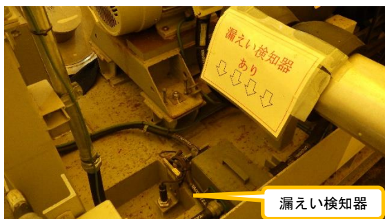
(写真 3) 漏えい検知器の設置状況
