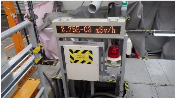
(写真 3) 線量表示器の設置状況
