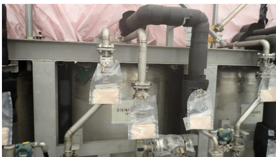
(写真 2) 漏水確認の対策
