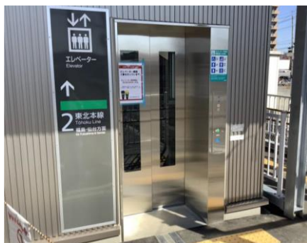
（エレベーター）
