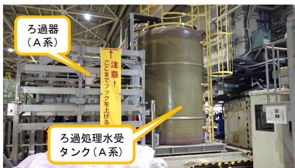
(写真1-1) ろ過器及びろ過処理水受タンク (A系) の設置状況
