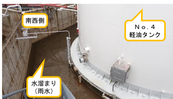
(写真 2－1) N o . 4 軽油タンク南西側の防油堤内の水溜まりの状況
