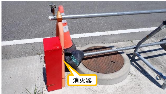
(写真 4—1) 道路側の消火器設置の状況
