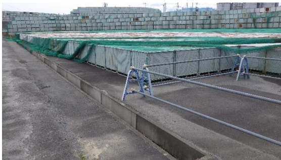
(写真 1-1) 一時保管エリア○におけるコンテナ の保管状況①
