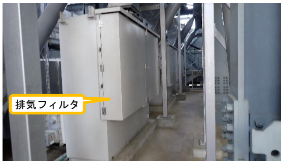
(写真 4) 排気フィルタの設置状況
