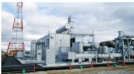
福島送電（株）都路変電所【田村市】
