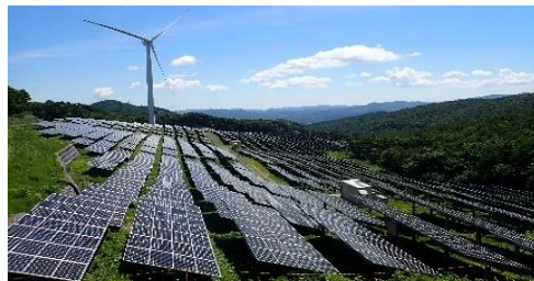
いいたてまていな再エネ発電所【飯舘村】
