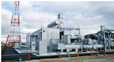
福島送電（株）都路変電所【田村市】
