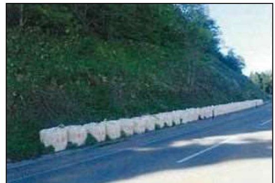
落石対策予定箇所 （国道121号 中在家丙工区 喜多方市）
