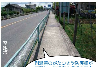
整備前 側溝蓋のがたつきや防護柵が変形し、歩行者の通行の安全性・快適性が損なわれていました。
