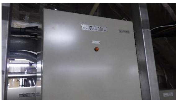
(写真1－5) PCVガス管理システム分電盤 (B)
