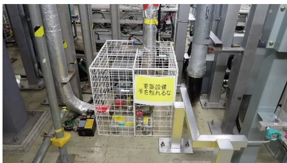
(写真1－3) ダストモニタ吸引ポンプ
