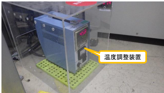
(写真 3) 温度調整装置
