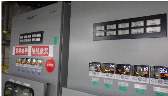
(写真 2 - 2) PCV ガス管理設備現場制御盤
