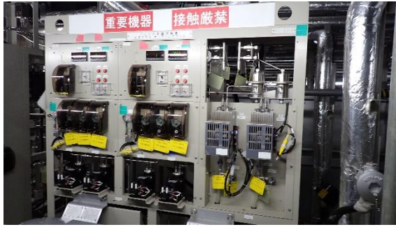
(写真 2 - 1) PCV 排気監視装置水素モニタサン プリングラック
