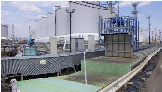
(写真 1－4) B－1 排水路設備の状況 (電動開閉ゲート及びB排水路)
