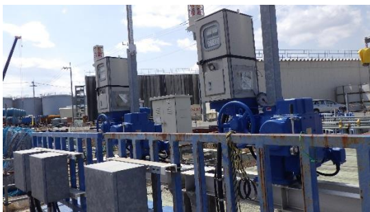
(写真 2－1) 電動開閉ゲート (B C－1) の状況
