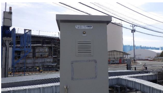
（写真 1－2） C排水路の関連設備 （C－1 ゲート設備の配電盤）
