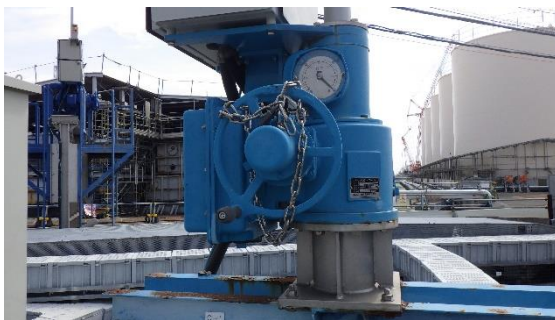
（写真 1－1） C－1 電動開閉ゲートの状況 （全開）
