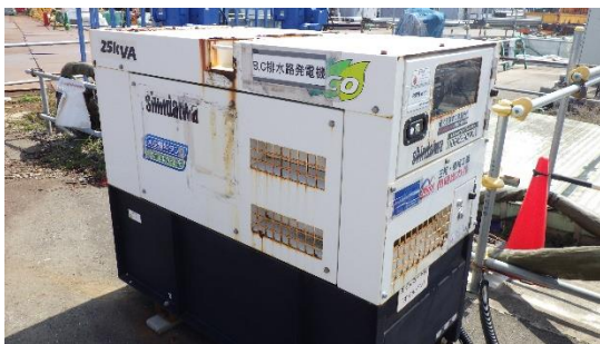
(写真 2－2) 電動開閉ゲート (B C－1) に設置 されている発電機の状況
