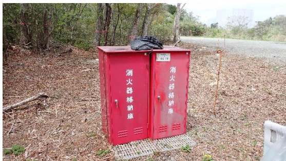
(写真4) 消火器の設置状況
