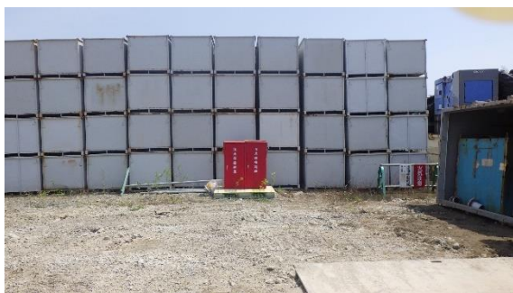
(写真3) 消火器の設置状況
