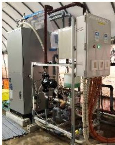
ヒートポンプ・機械室
