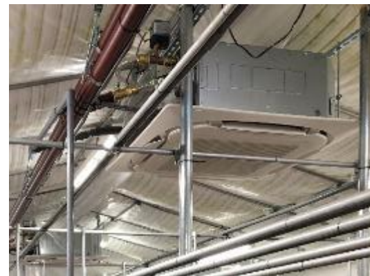
ファンコイルユニット（3台）
