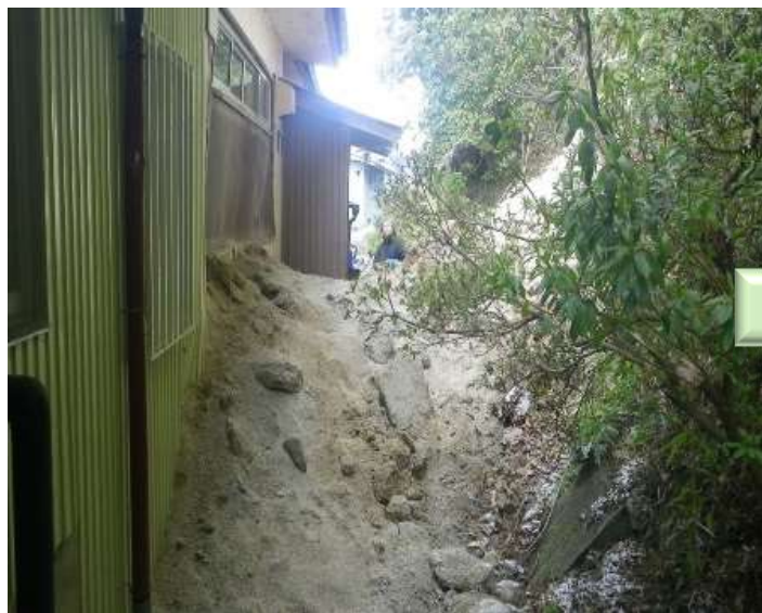
H27.9 関東・東北豪雨による崩落
