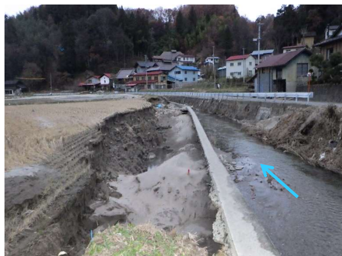
安達太田川（二本松市太田） 被災状況
