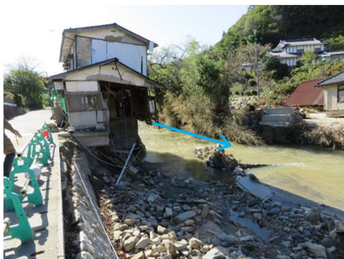
広瀬川（川俣町小島） 被災状況
