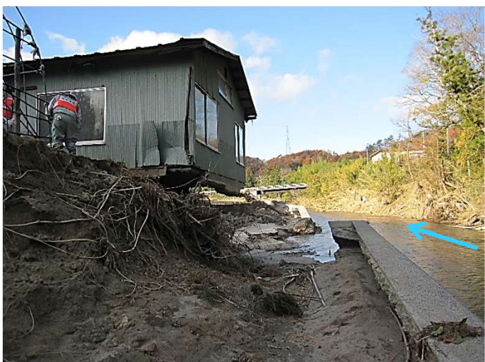
移川（二本松市上長折） 被災状況
