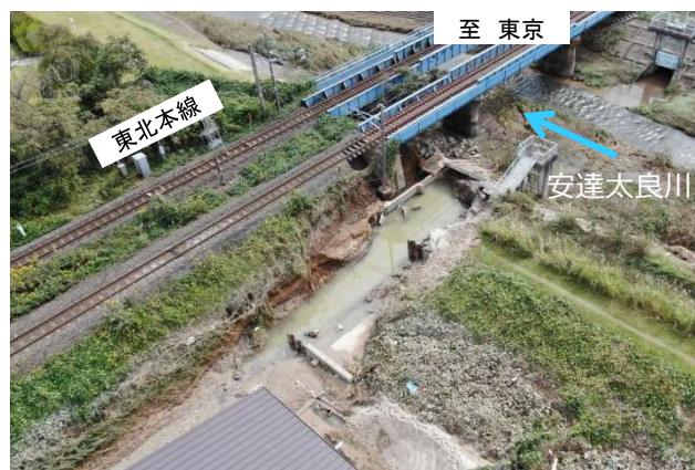
安達太良川（本宮市本宮） 被災状況
