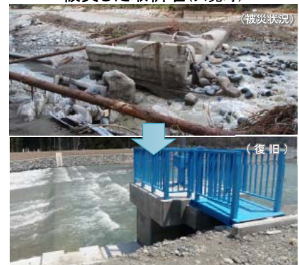
被災した取桝堰(只見町)
