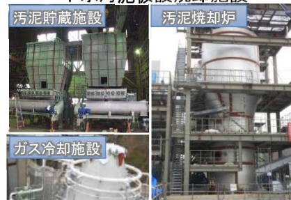
福島県県北浄化センター 仮設汚泥乾燥施設
