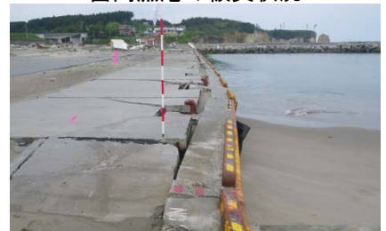
富岡漁港の被災状況
